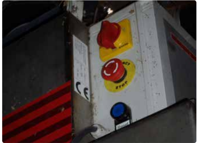
Figur 7. Et eksempel fra kvægstalden – her en mini strømaskine med CE-mærke. Nødstoppet skal også være CE-mærket, da det er en sikkerhedskomponent. .
